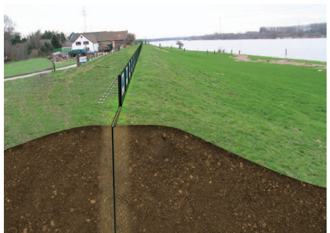
Bild 2. Die Deichsicherungsplatten aus lebensmittelechtem Polyethylen lassen sich schonend in den Deich einbauen – mit mobilen Deicherhöhungsplatten kann der Deich bei Bedarf schnell und zuverlässig erhöht werden
